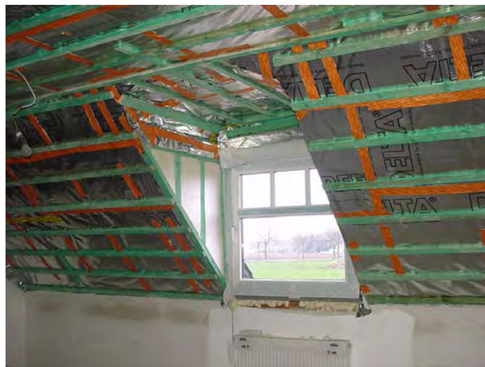
Dachdämmung mit Dampfsperre aus Aluminium-beschichteter Folie; Fenster mit Wärmeschutzglas; Kunststoff-Fenster-rahmen mit Metallkern
