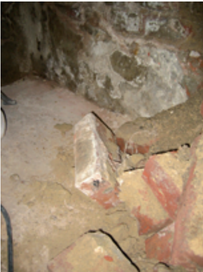
Das Strangmyzel wuchs bis in die Mauer hinein (hier auf vorsichtig herausgeschlagenen Ziegeln der inneren Steinschicht zu sehen)
