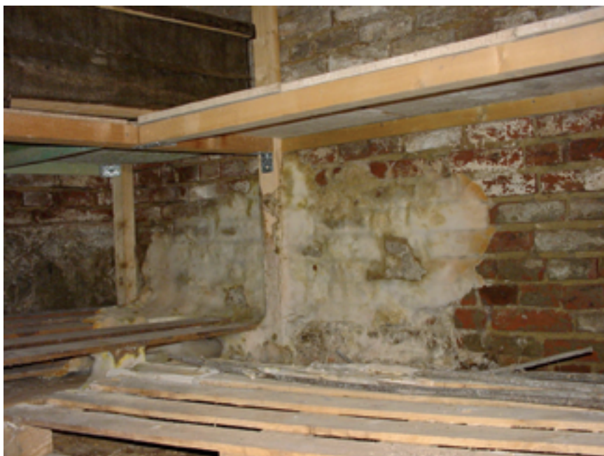
Befall mit Echtem Hausschwamm im Keller eines Fachwerkhauses
